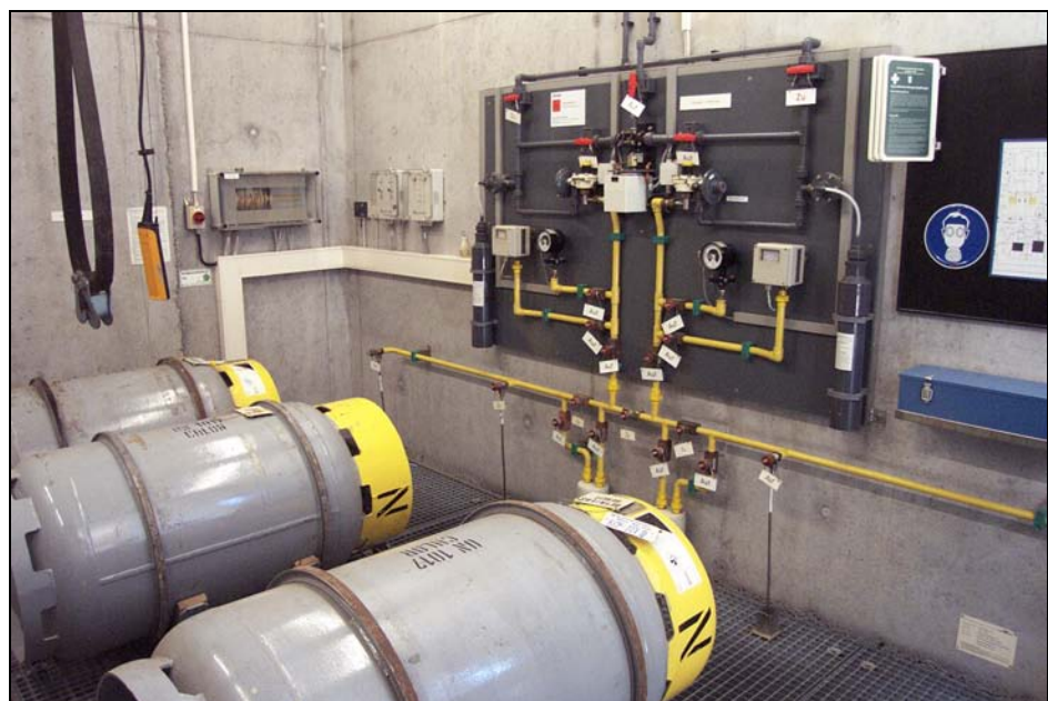
Beispiel für einen Chlorgaslagerraum (Fässer 500 kg)
