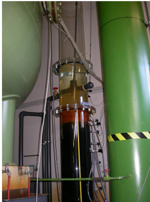
Versuchsfilter im Wasserwerk
