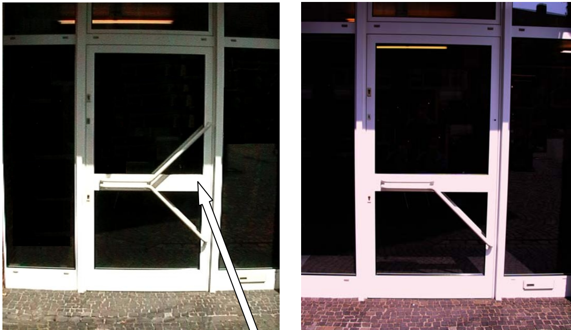
Abb. 5.31 Der auffällig nach oben abgewinkelte Handgriff an der Tür fordert zum Greifen und Öffnen auf. Die abgebildete Tür ist aber auf der rechten Seite angeschlagen, deshalb lässt sich die Tür mit einem Griff an dieser prominenten Stelle nicht öffnen. Das Entfernen der oberen Griffstange erhöht die Gebrauchstauglichkeit mit der Aufforderung zum Greifen an der richtigen (linken) Seite, da die Griffstange auf der falschen (rechten) Seite nach unten abgewinkelt ist und von Erwachsenen dort nur unter Schwierigkeiten angefasst werden kann.
