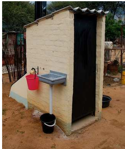
Abbildung 61: Toilette ohne Wasserleitung (susana)
