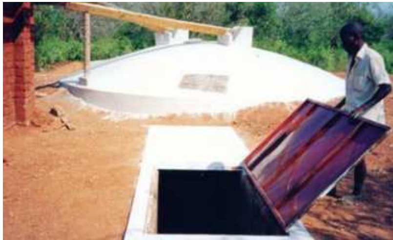
Abbildung 22: Unterirdischer Ferro Cement Tank
