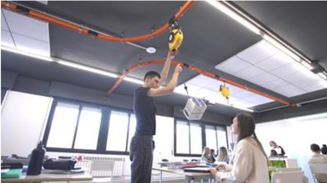
Abbildung 6.7: Frei bewegbare Steckdosen an der Decke (Ethazi Tknika, 2021)
