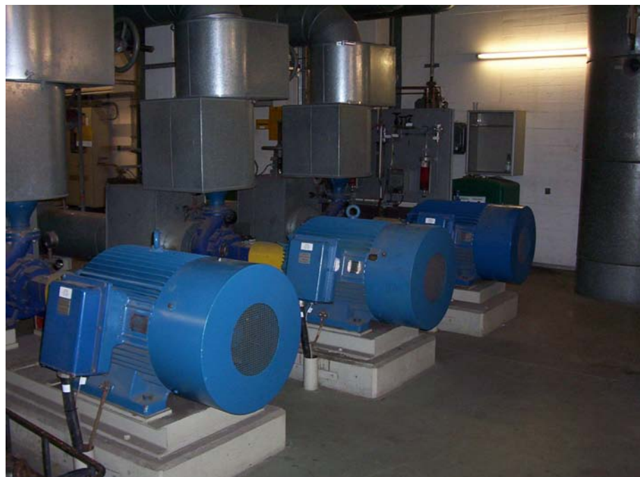
Pumpstation einer Fernwärmeerzeugungseinheit
